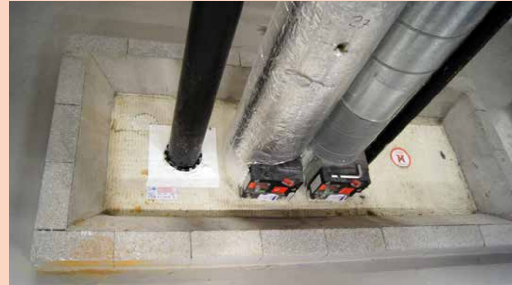
PERFECT VOLGENS TESTRAPPORT UITGEVOERDE BRANDWERENDE VOORZIENINGEN IN DE TECHNISCHE RUIMTE VAN HET STEIGENBERGER AIRPORTHOTEL BIJ SCHIPHOL.
